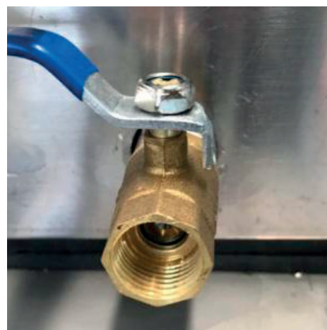
Кран под левой панелью корпуса
